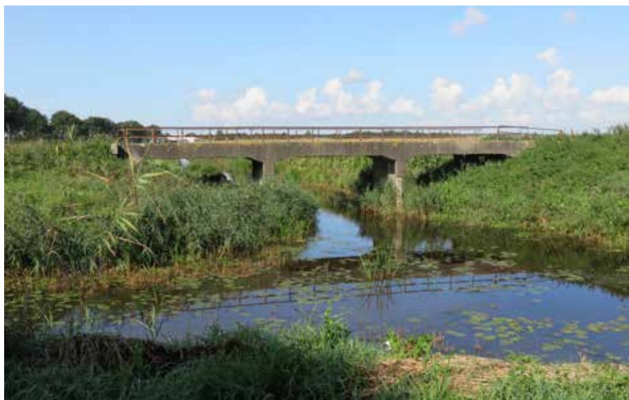
Lage waterstand in Gracht, brugfunderingen boven water
